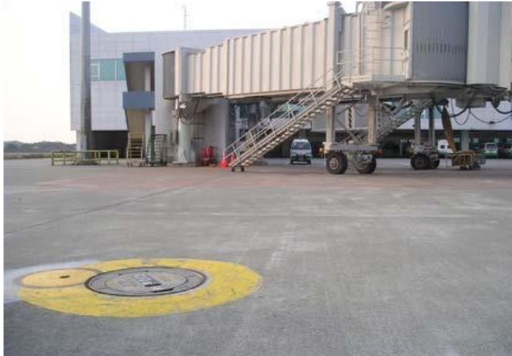
圖 4.21 機坪油栓蓋板
